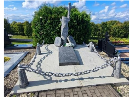
4 pav. 2–5 mm skersmens plyšiai S. Daukanto kapavietės postamente indikuoja netolygų gruntų sėdimą.
