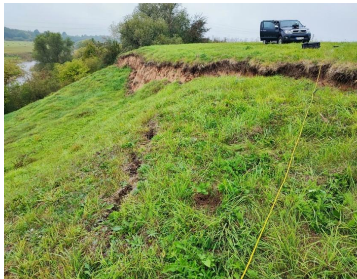
11 pav. 275 m ilgio ET profilis, atliekamas Ventos upės šlaite per besiformuojančią nuošliaužą
