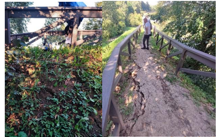
9 pav. Plyšiai stebimi aukštesnėje atragio dalyje (keteroje) abipus turėklų išilgai tako ir griovos šlaito viršuje.
