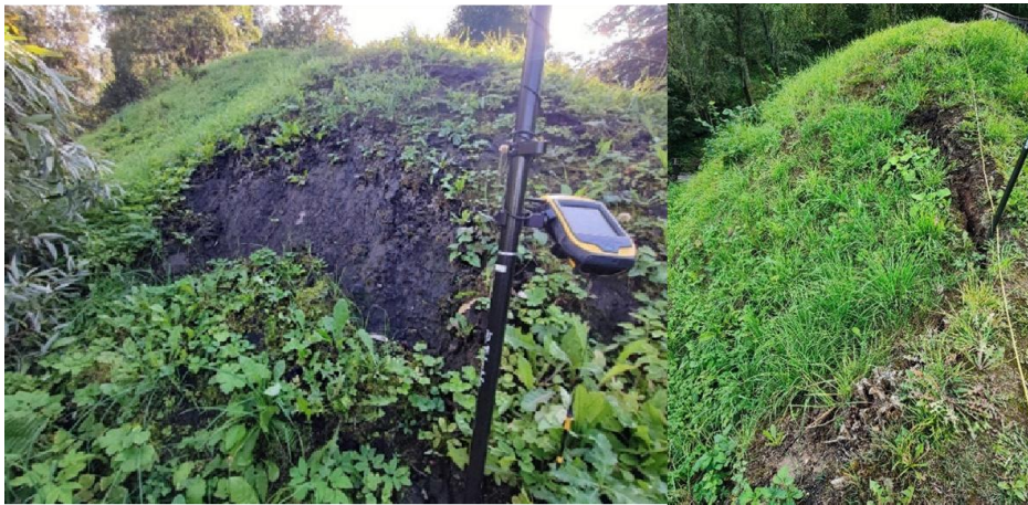
8 pav. Nuošliaužos atragyje: kairėje – mažesnė (1–1,5 m aukščio slysmo plokštuma); dešinėje – besiformuojanti nuo pat atragio keteros 18 m ruože (3–7 cm pločio ir apie 0,5 m gylio plyšys prof.).
