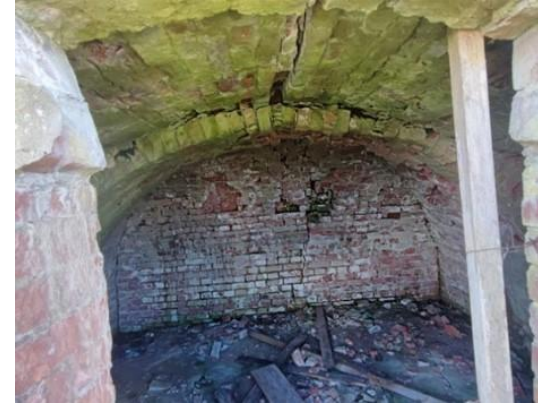
3 pav. Plyšiai griūvančioje kriptoje ŠR kapinių dalyje (įgilinta viršutinėje šlaito briaunoje)
