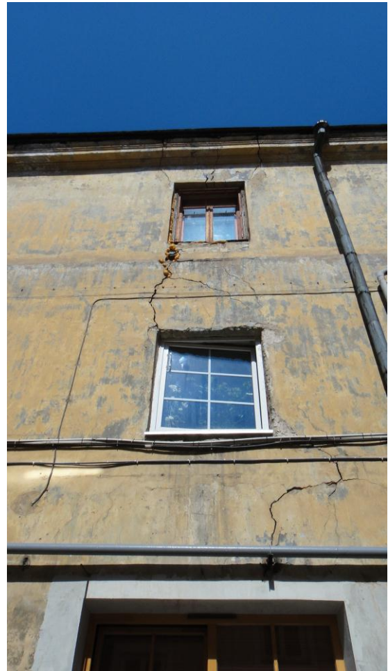
29 pav. Pastato deformacija Pilies gatvėje 36
