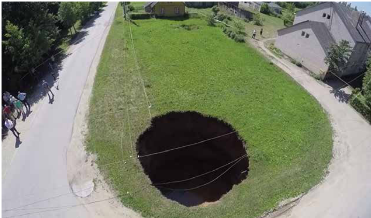
5 pav. Saločiuose, Vytauto ir J. Basanavičiaus gatvių sankryžoje, šulinio formos 18 m gylio (iki vandens 6,5 m) ir 7,5–9,5 m skersmens įgriuva atsivėrė 2016-06-23 (Ramūnas Stulga, https://www.youtube.com/watch?v=VoLusx7-aYQ ). Į pietus už 20 metrų yra žinoma 1990 metais atsiradusi nedidelė smegduobė, o maždaug už 30 metrų – 2013 metais įgriuva buvo sugadinusi Basanavičiaus gatvės dangą (abu objektai tolimame plane prie geltono namo)
